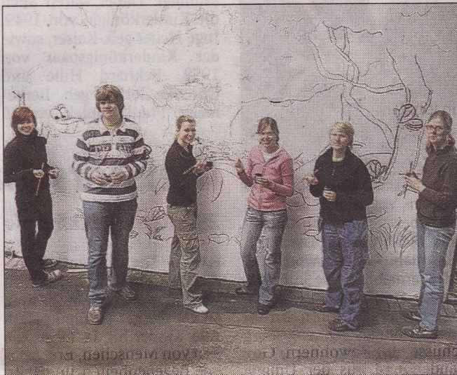
Die Außenfassade des Kindergartens bekommt von den freiwilligen Helfern einen neuen Anstrich. Foto: Tanja Gieseke
